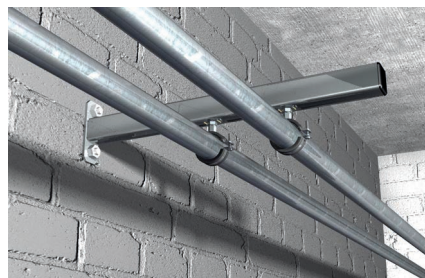
Трубопроводы, закрепленные на консолях
