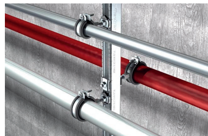
Горизонтальное крепление трубопровода
