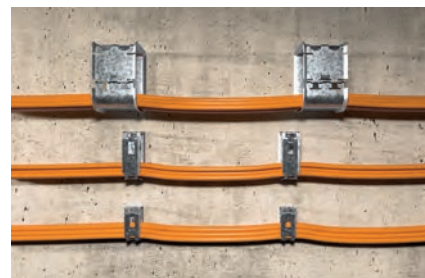
крепление кабелей к стене
