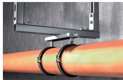
Крепление трубопровода на подвижной опоре
